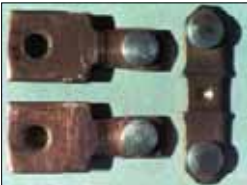
Загальний вигляд відновлених контактів
