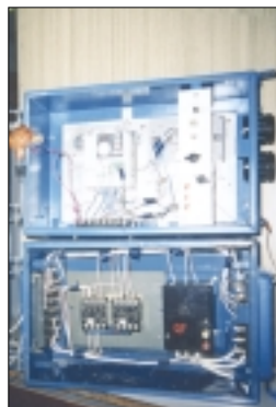
Зовнішній вигляд станції керування витяжною вентиляцією
