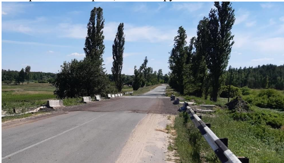
Рис. 2. Фрагмент зруйнованого мосту
