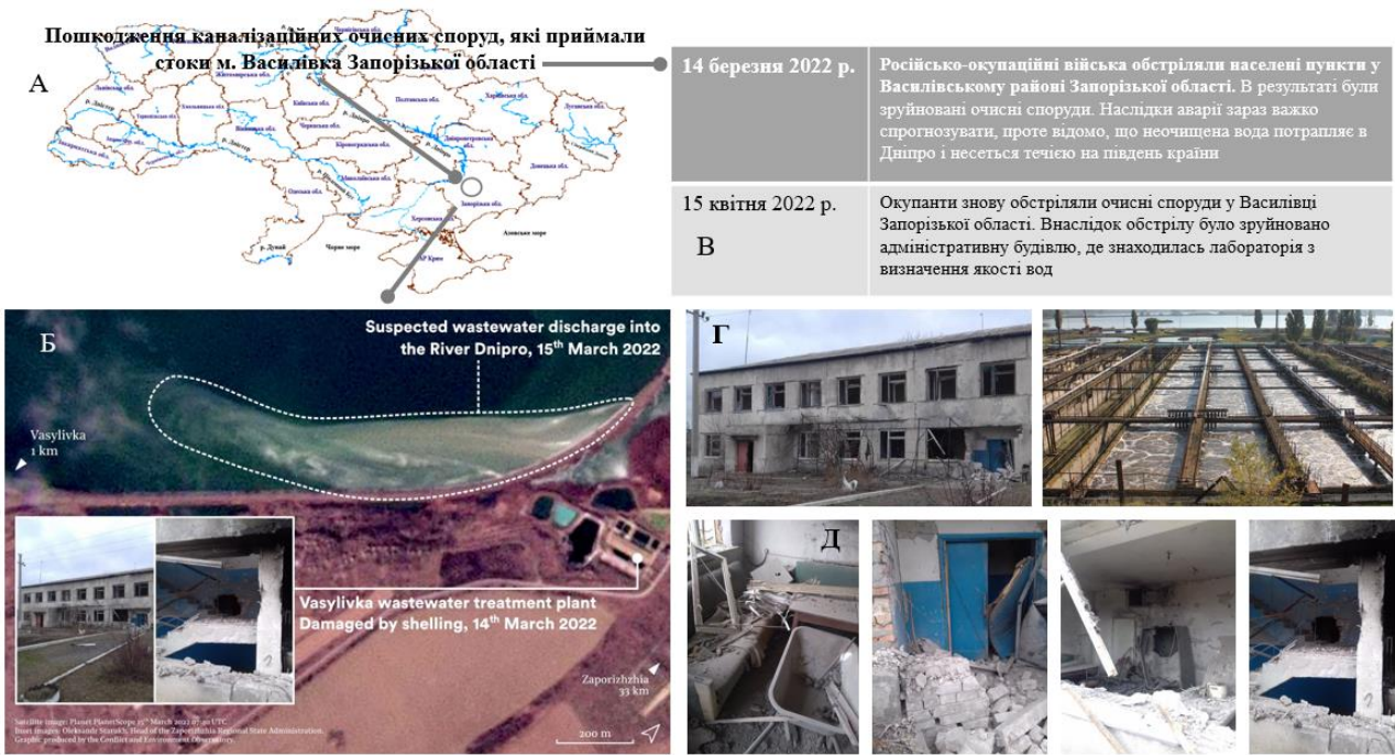
Рис. 2.11. Інфографіка пошкодження каналізаційних очисних споруд м. Василівка Запорізької області (підготовлено на основі літературних джерел: А - [4]; Б - [29]; В - [29, 48]; Г - [48]; Д - [49])
