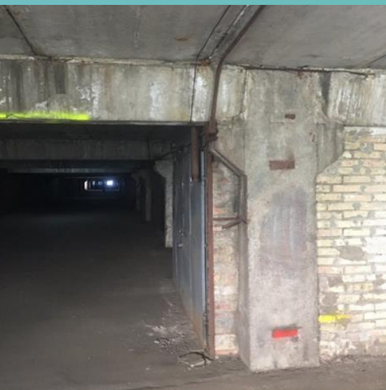
Рис. 11 Вузол спирання міжповерхових ригелів перекриття трапециєвидного перерізу на консолі збірних залізобетонних колон на позн. +11,200 (4 поверх), по осі «1» в осях «Д–Е»
