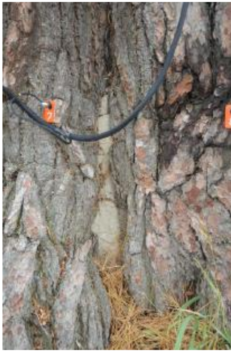
Рис. 8. Фіксація дупла між кореневими лапами сосни, розміщені з південної сторони стовбура (сенсори 7-8). Дупло забетоноване.
