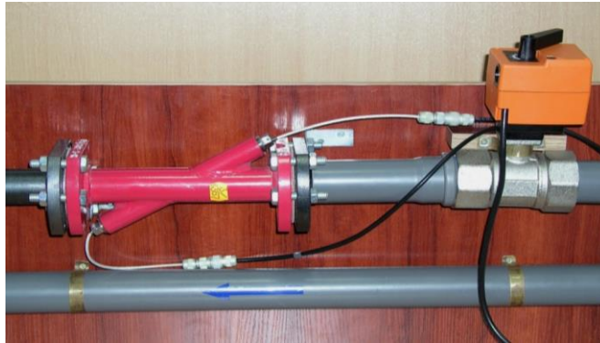
Рис. 1. Загальний вигляд фрагменту прямого та зворотного трубопроводів теплового пункту з витратомірною ділянкою тепловодолічильника СВТУ-10М і клапаном вузла регулювання витрат теплоносія (макет)
