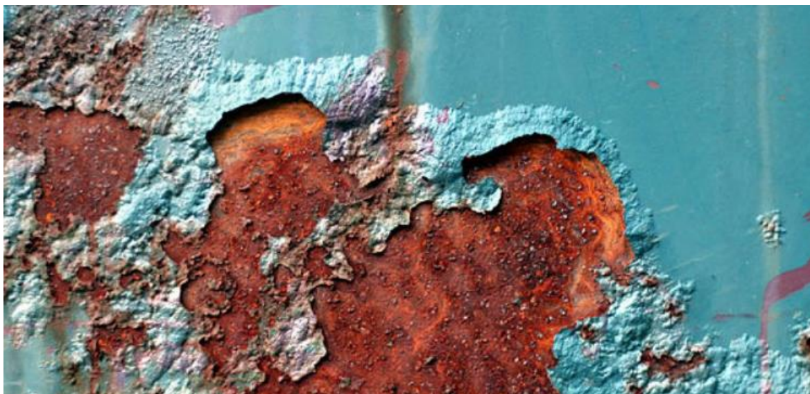
Рисунок 1 – Приклад корозії поверхні металу
