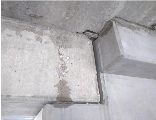
Рисунок 1 – Зовнішній вигляд опорної зони ригеля перекриття з тріщинами
