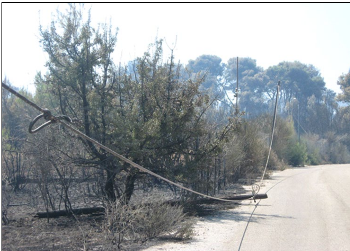
Пошкодження пожежею лінії електропередачі (фото Gavriil Xanthopoulos)
