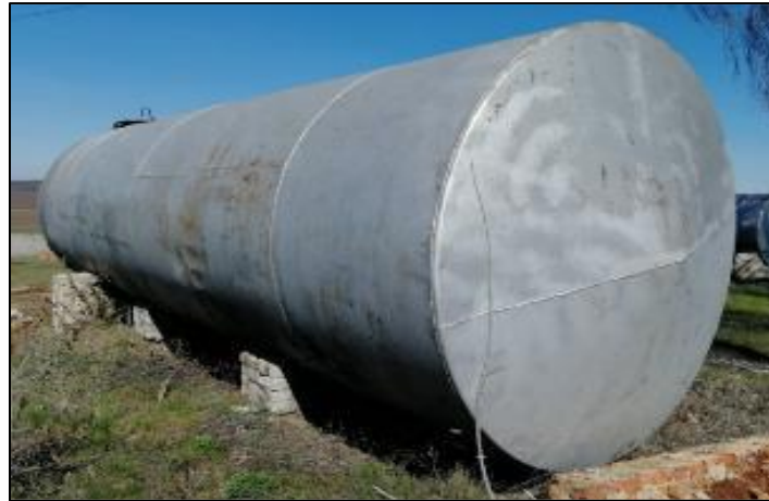
Рис. 30. Пожежний резервуар для забору води обсягом 50 т
