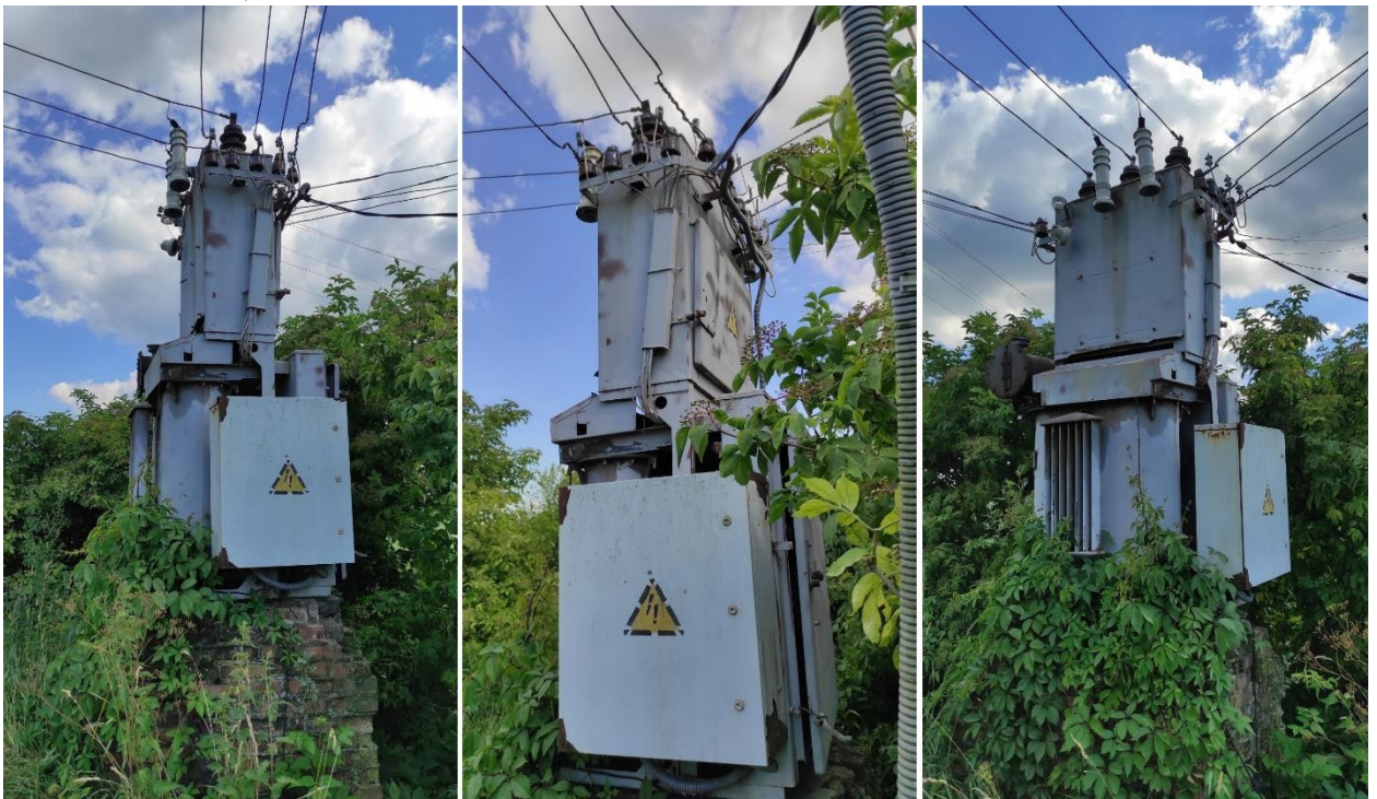
Рисунок 1. Трансформаторна підстанція в умовах навколишнього середовища
