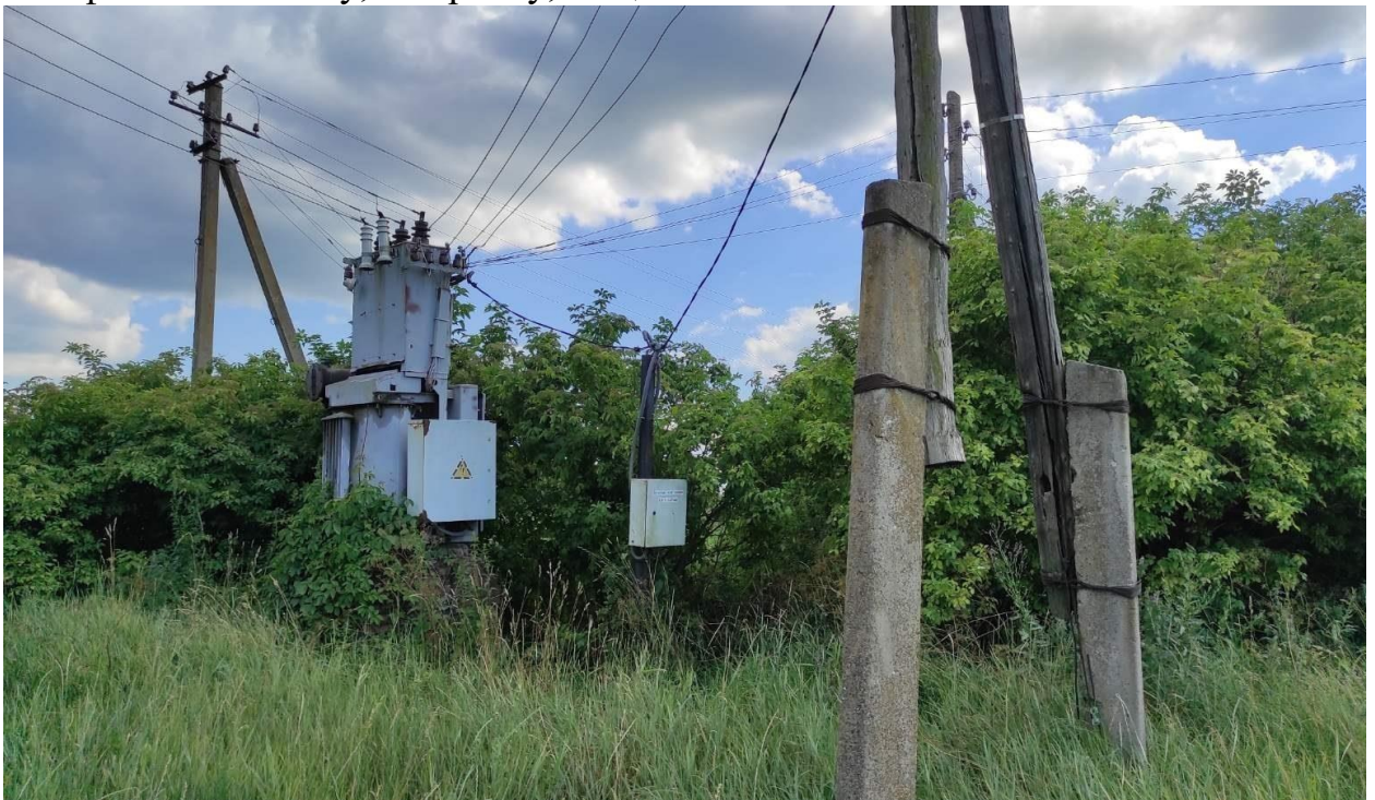
Рисунок 1. Трансформаторна підстанція та прилеглі до неї елементи
