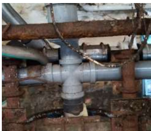
Хрестовина вакуумної лінії яка заглушена в точці зливу конденсату
