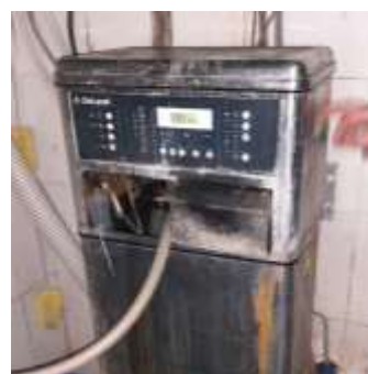
Вихід з ладу електроніки автомата промивки
