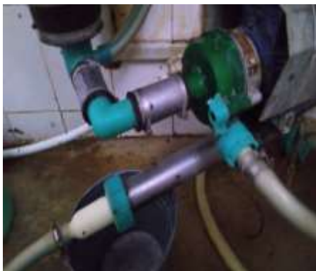
Втрати вакууму від пошкоджень корпусу молочного насоса
