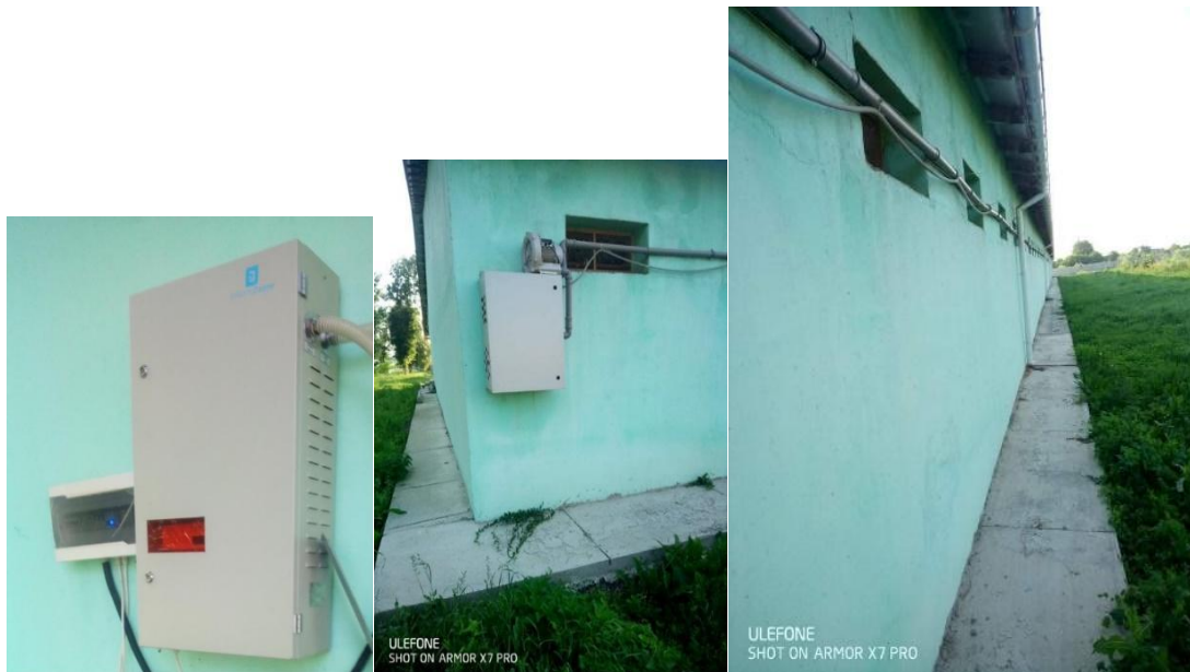
Рис. 3.11. Загальний вигляд озонатора та розведення труб на стінах приміщення (фото автора)
