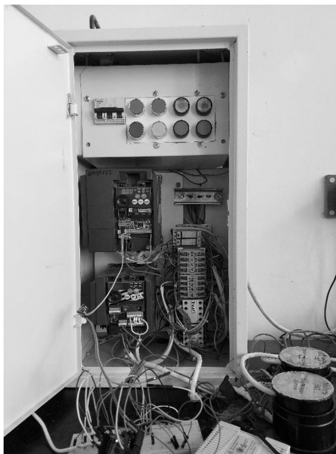
Рисунок 4.2 – Перетворювач частоти Mitsubishi Electric FR-E740-060
