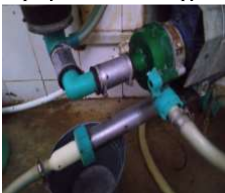
Втрати вакууму від пошкоджень корпусу молочного насоса
