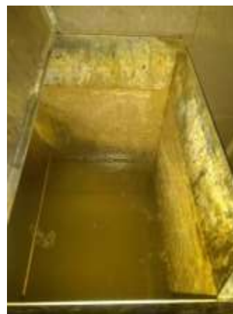
Відкладення через погану якість води
