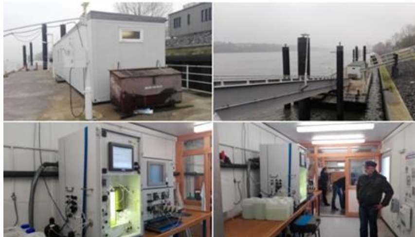
Рис. 4.4. Комплексна станція моніторингу якості вод контейнерного типу
