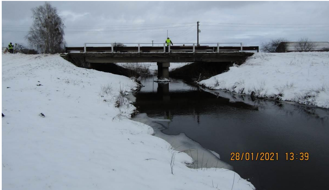
Рис. 1. Стан мосту в момент обстеження
