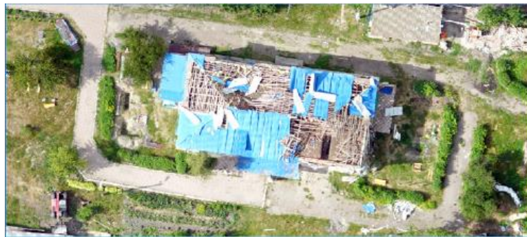
Рисунок 1. Фото зруйнованого об'єкту моніторингу
