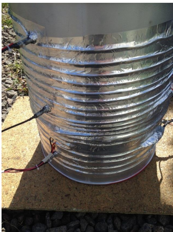
Рис. 3.21. Електричний нагрівальний кабель прокладений на зовнішній стінці біогазового реактора
